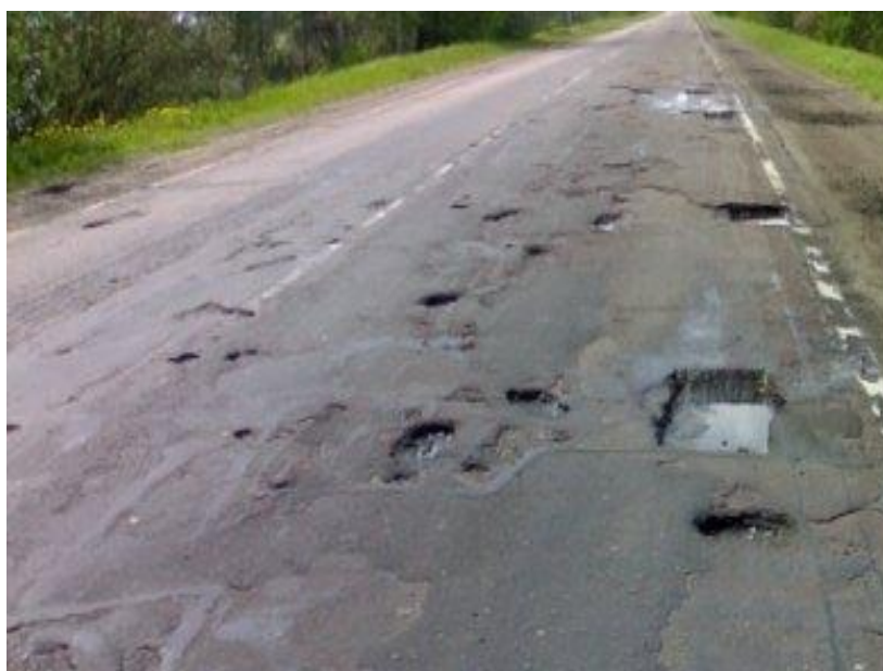
Рис. 2. Деформации дорожного полотна на км 136+00 и км 167+60 автомобильной дороги М-7 «Волга»
